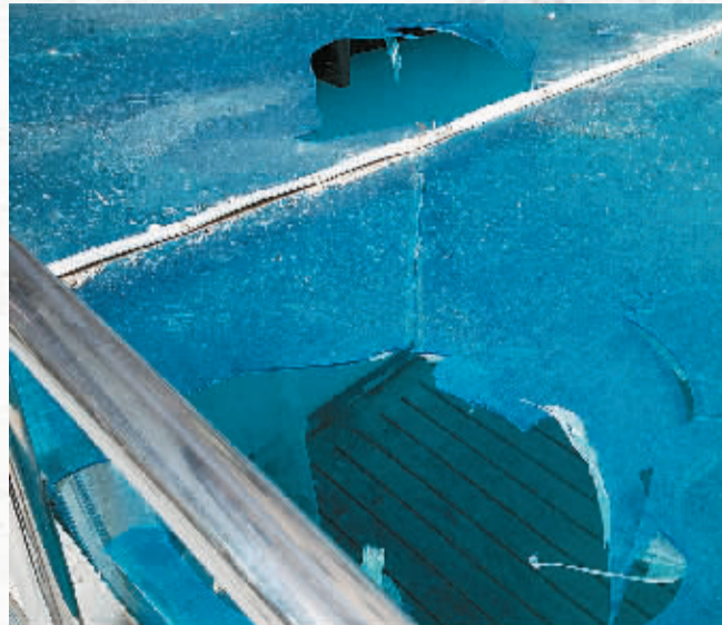
小区地下车库顶棚被掉落的钢管砸出两个窟窿。
